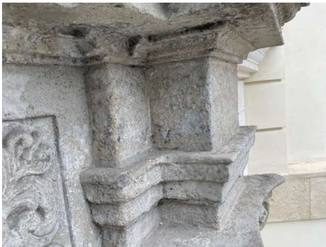
Pohled na stav kamenného rozeklaného frontonu – jeho spodní části a kamenného vlysu pod korunní římsou
