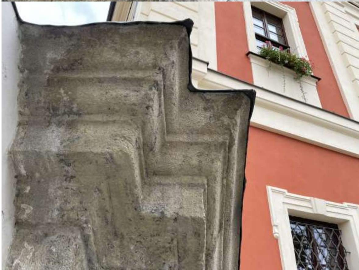
Pohledy na různé stupně povrchové degradace omítkových vrstev s prasklinou v plombě a stav podhledu kamenné hlavice kryté olověným plechem
