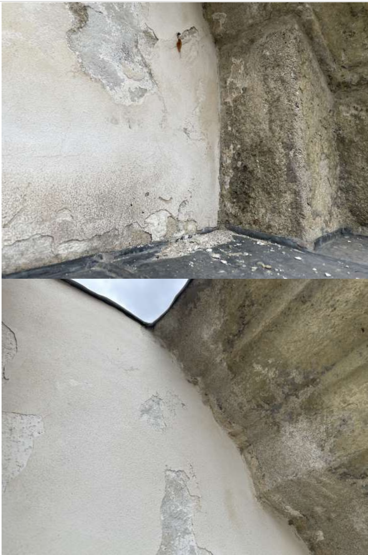
Pohledy na různé stupně povrchové degradace omítkových vrstev
