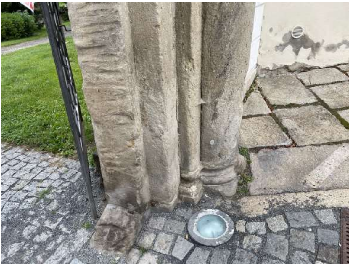
Pohledy na spodní části kamenné architektury s různými stupni jeho degradace
